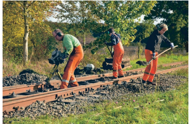
Der Schwellensatz wurde teilweise ersetzt und mittels Benzinstopfhammer nachgestopft – eine wahre Knochenarbeit.
