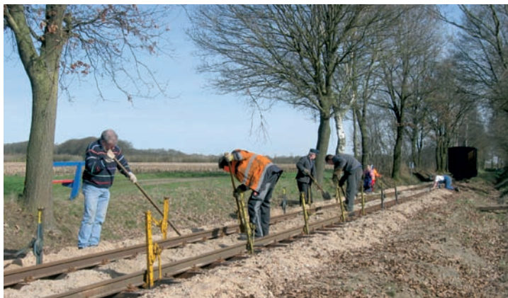
Mit Gleiswinden wird das Gleis auf die gewünschte Stopfhöhe angehoben und mit Stopfpaddeln gestopft.
