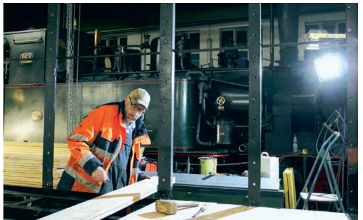
Bernd Fütting beim Einpassen der Fußbodenbohlen. Bruchhausen-Vilsen, 15. Februar 2014. Alle Fotos auf dieser Seite: RM
