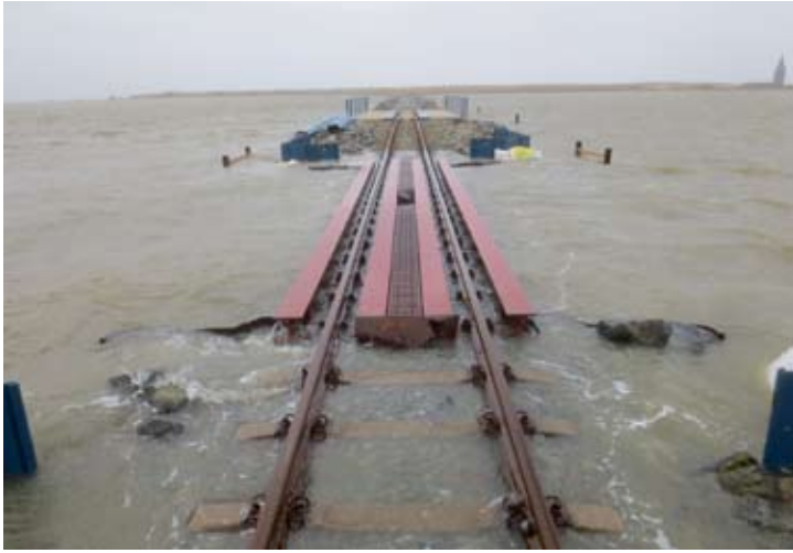
Auf der Insel Wangerooge wird die Strecke vom Anleger zum Bahnhof bei Hochwasser immer wieder überflutet, sodass der Zugverkehr eingeschränkt werden muss. Aus diesem Grund sollte im Zuge der Erneuerung der EÜ Priel 3a auch das angrenzende Gleis und die EÜ Priel 3b höhergelegt werden. 24.01.2024
