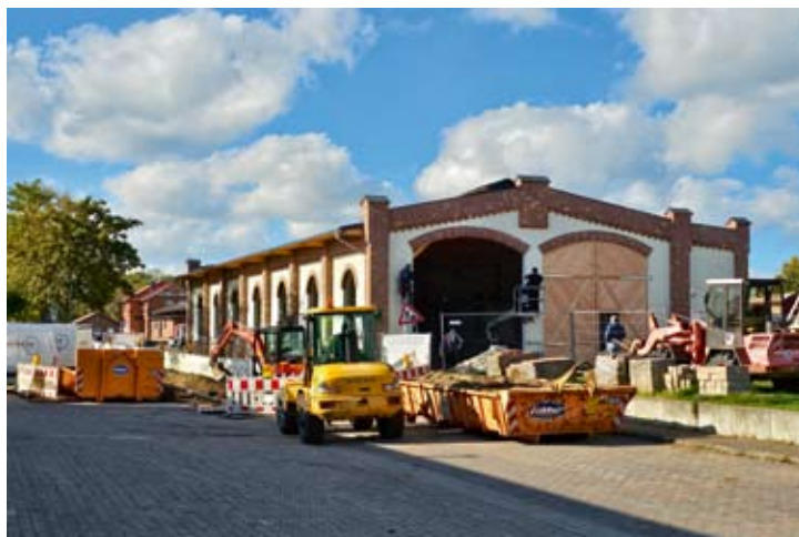
Zwei Monate später war bereits das Gerüst um den Lokschuppen herum abgebaut, die Schuppentore wurden montiert und die Straßen- und Tiefbauarbeiten zur Verlegung der Gasleitung liefen. 07.10.2024, fünf Fotos: RM
