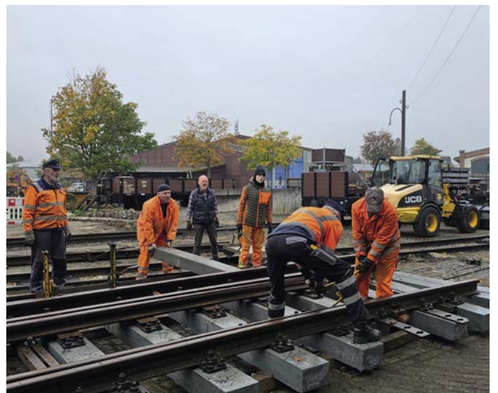
...wird die Weiche wieder zerlegt und bis zum Einbau im Herbst 2026 eingelagert.
